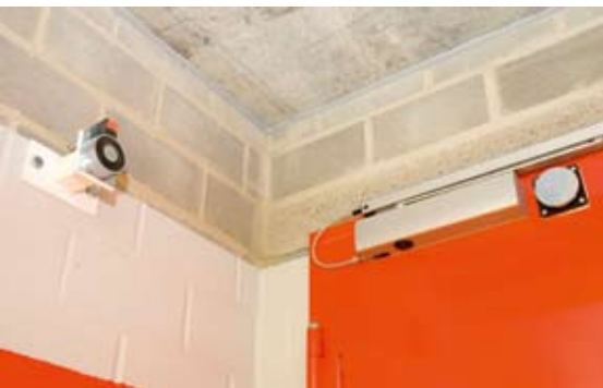
Bild 4: Haftmagneten halten Durchgänge geöffnet. Sie sind mit den Rauchmeldern gekoppelt. Bei einem Brand schließen die Türen selbsttätig
