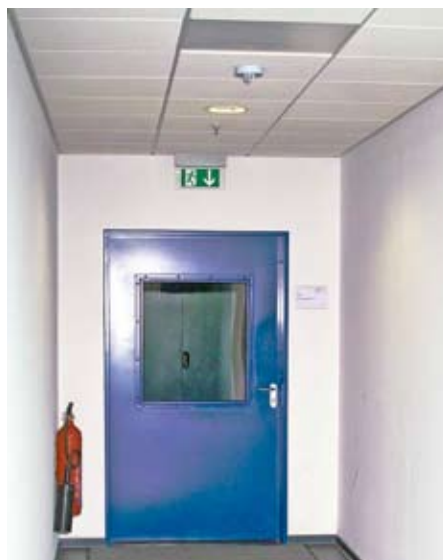
Auch in den Gängen zwischen den einzelnen Betriebsteilen besteht Feuerschutz durch die Brandmelde- und Sprinkleranlage, mobile Geräte und baulichen Brandschutz.
