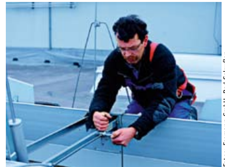
Dieser Mitarbeiter schaut nach, ob die einzelnen Systemkomponenten nicht beschädigt sind
