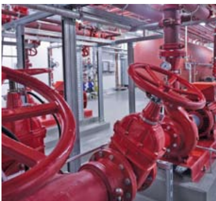
Von hier werden die 41000 Sprinklerköpfe versorgt
