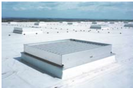
Natürliche Colt-Rauchschrz (hier Typ „EuroCO“) werden vorzugsweise in einschossigen Produktionshallen, Einkaufszentren, Gewerbebetrieben oder Atrien eingesetzt
