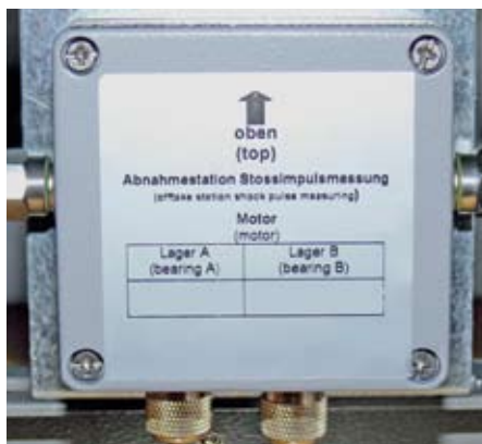
Anschlussbox am RDM 56/57-Entrauchungsventilator für Handmessgerät
