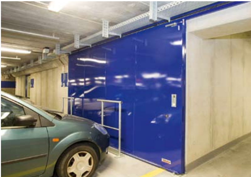
Bild 1: Standard-Lösung in Tiefgaragen: Feuerschutz mit Schiebetoren
