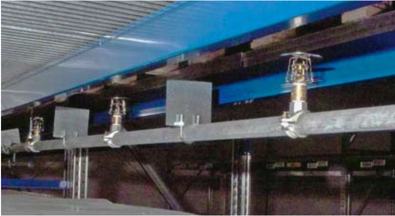
Die Löschanlage ist auch im Hochregallager besonders wichtig.
