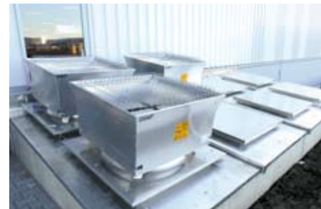
Bei mehrgeschossigen Bauten und in Kellerräumen ist der maschinelle Rauch- und Wärmeabzug (hier Typ „Liberator“) zwingend erforderlich
