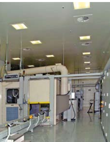
In den Fertigungsräumen ist flächendeckend eine trocken-vorgesteuerte Sprinkleranlage installiert.
