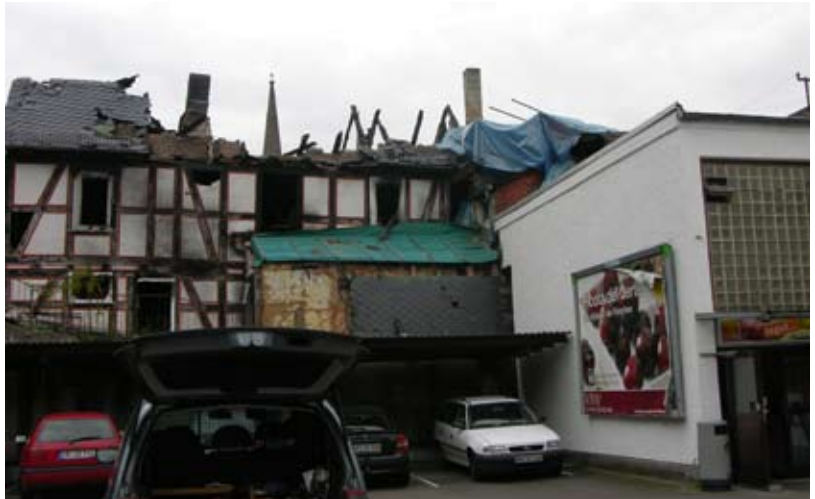
Beim Abbruch eines Fachwerkhause kam es zu einem Brand. In diesem Fall konnte die Feuerwehr zumindest ein Übergreifen der Flammen auf einen Lebensmittelmarkt verhindern
