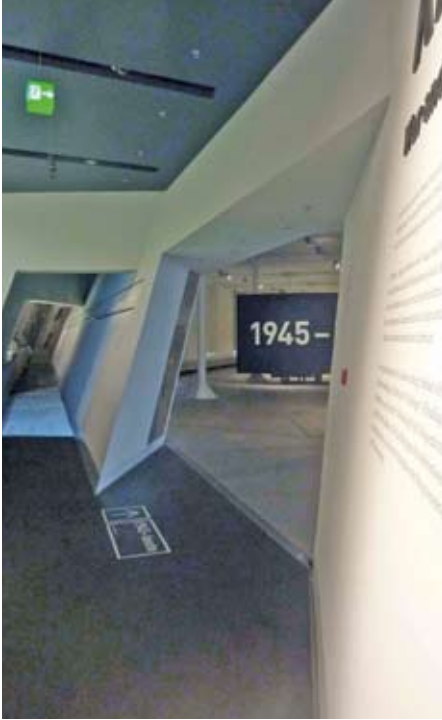
Bild 10: Öffnung in der Keilwand mit Sprühflut-anlage
