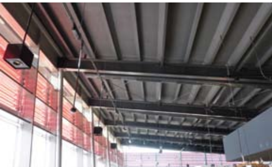
R30-platinierte Stahlkonstruktion mit Decklack RAL 7035 (grau) – viel natürliches Licht
