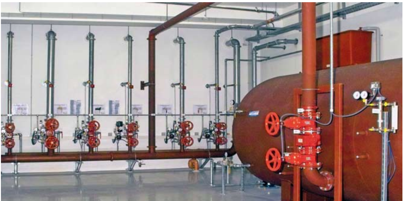
Herzstück des technischen Brandschutzes: Die Sprinklerzentrale mit dem Druckluftwasserbehälter
