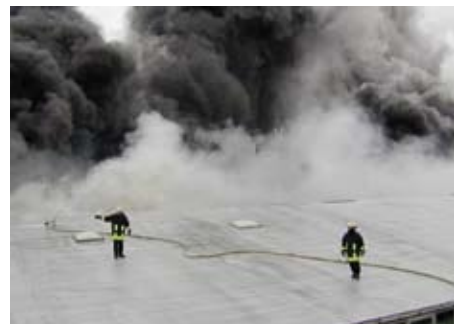
Ein Brand bei Abbrucharbeiten greift auf andere Gebäudeteile über
