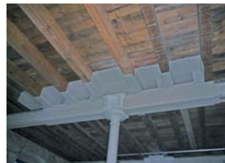
Bild 2: Blick auf die mit Trockenbau in F30 ertüchtigte Stahl-Guss-Konstruktion unter der Holzbalkendecke
